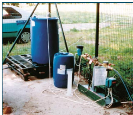
Rys. 1. Neutralizacja w sieciach kanalizacyjnych. Dozowanie do ścieków, INHITONE P1
