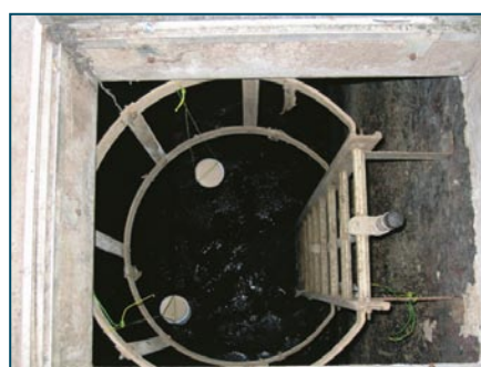
Rys. 6. Dezodoryzacja studzienek kanalizacyjnych, puszkii z żelazną kurtyną i urządzeniem z żelami AIRHITONE NVG
